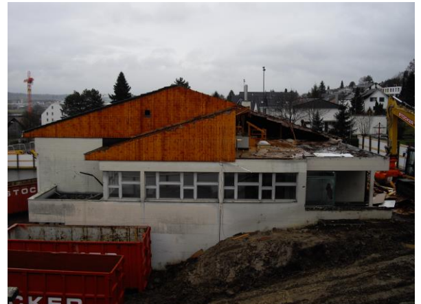
Das Dach wird schrittweise abgebaut. Neben dem Kindergarten wird eine Wasser- und Stromleitung verlegt. (9. März 2017)
